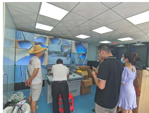
视频监控中心测试现场
